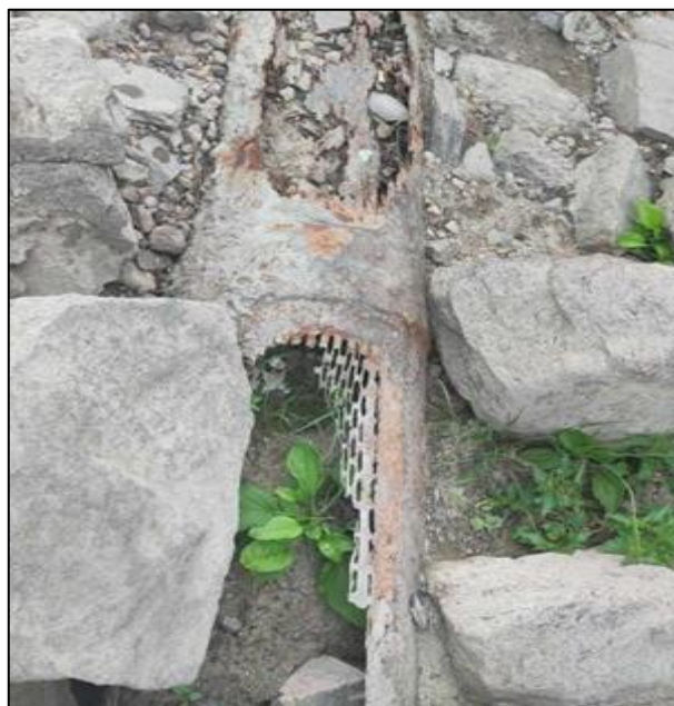
Fot. 2 Pozostałość skorodowanego drenu (Fot. P. Bartold 2024)
