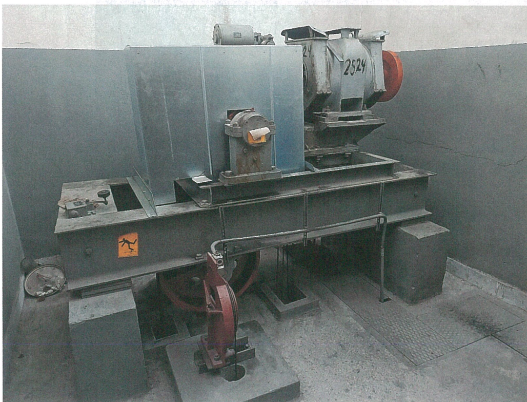
DŹWIG nr ewidencyjny 64584
