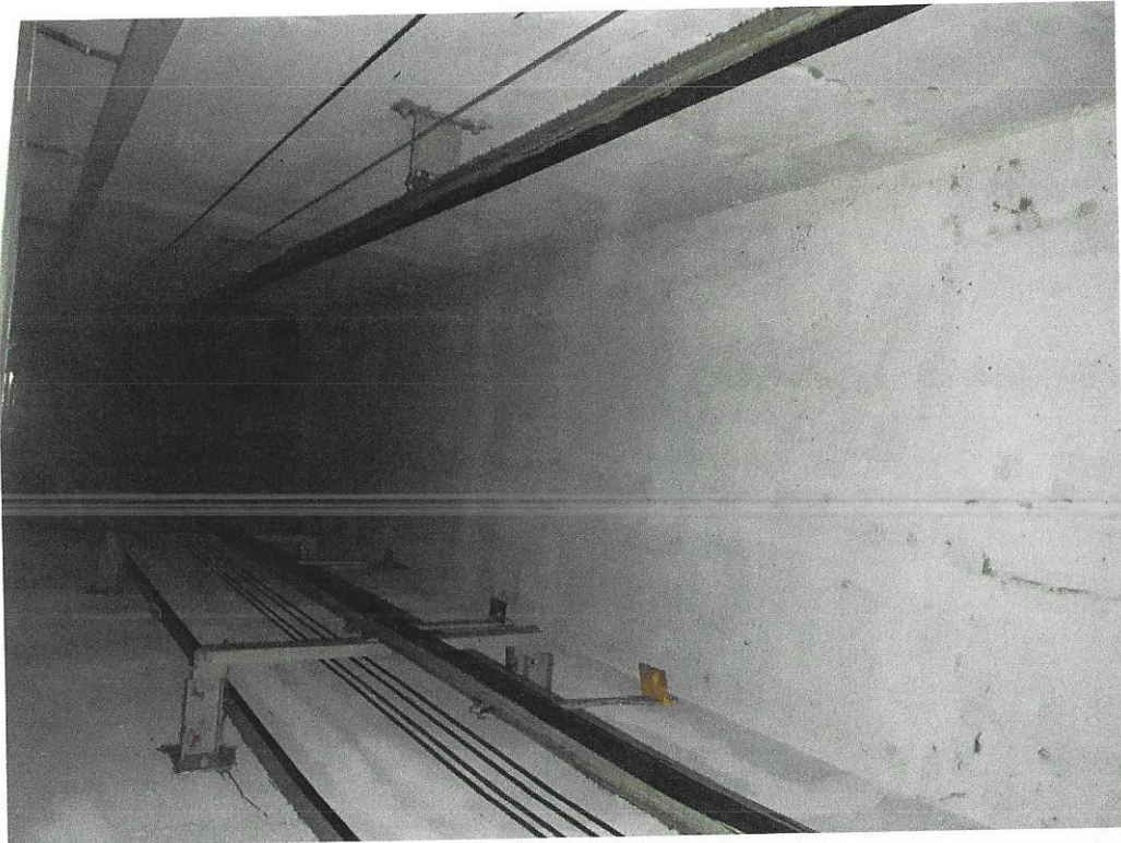
Szyb DŹWIGU I
