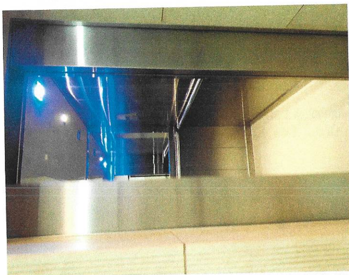
Widok kabiny DŹWIGU I
