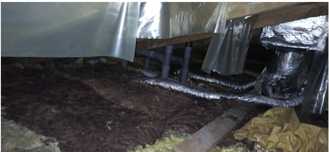
Widok podłączenia wentylatorów dachowych wentylacji mechanicznej wywiewnej Widok połączenia odpowietrzenia pionów kanalizacyjnych z kominkami dachowymi wentylacyjnymi
