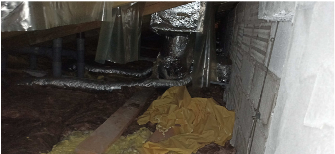
Widok podłączenia wentylatorów dachowych wentylacji mechanicznej wywiewnej
