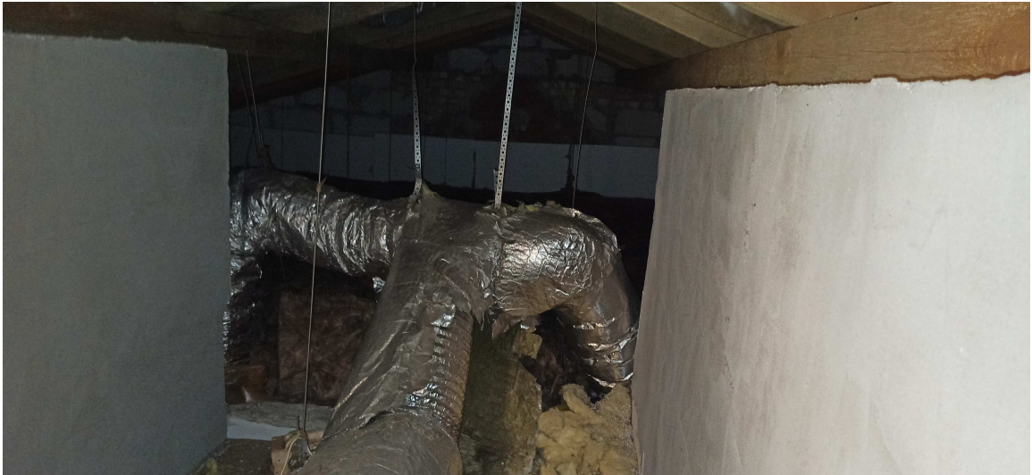
Widok połączenia kanałów wentylacyjnych na poddaszu nieużytkowym z kanałami wentylacji w poziomie parteru (spiro)
