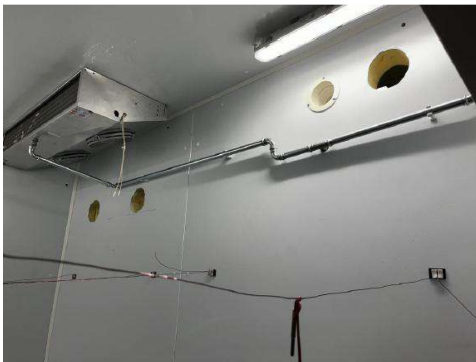
Rys. 11.3. Wymiennik ciepła zainstalowany wewnątrz dwustrefowej komory chłodniczej
